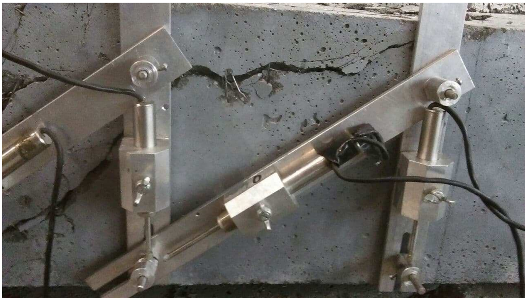
Rys. 7.21. Niezgodność nachylenia czujnika pomiarowego z trajektorią rysy ukośnej
