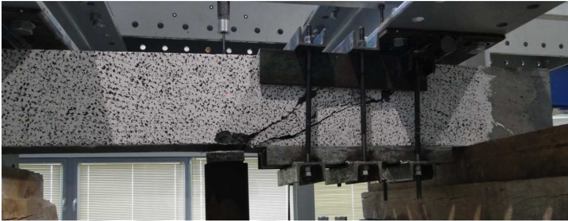
Rys.6.7. Ogólny widok belki po pierwszym etapie badania wraz ze stalowym gorsetem przejmującym siły ścinające w zniszczonej strefie przypodporowej (opis w tekście) [83], [127]
