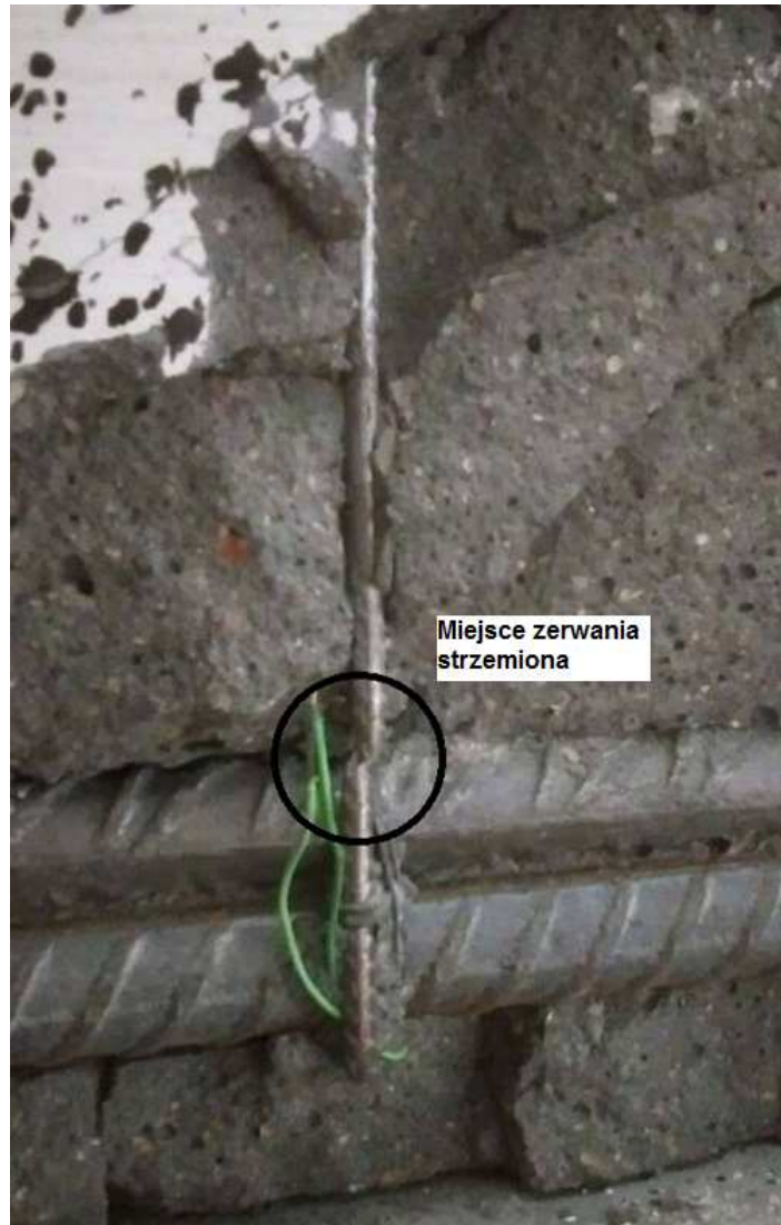
Rys. 7.26. Widok zerwanego strzemiona po wcześniejszym uplastycznieniu stali
