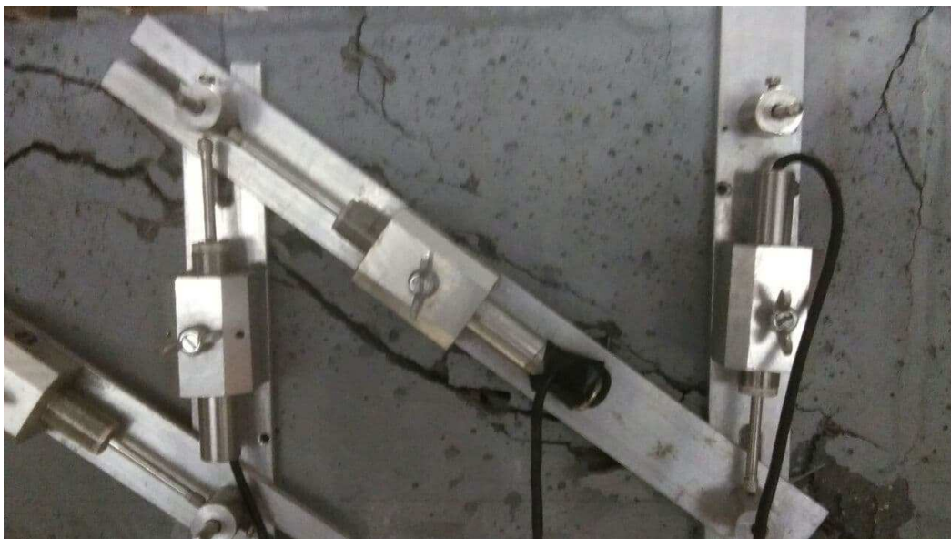
Rys. 7.22. Zbieżność nachylenia czujnika pomiarowego i rysy ukośnej
