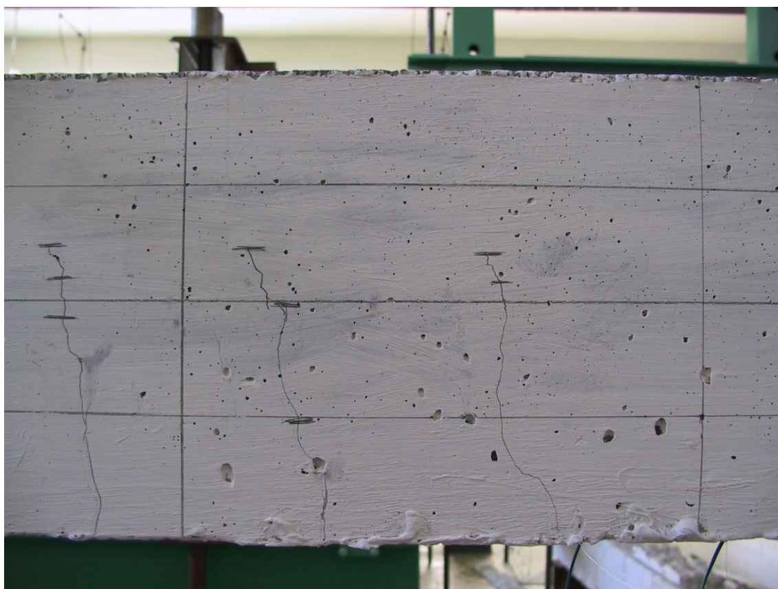
Rys. 6.5. Ogólny widok powierzchni bocznej belki z zaznaczoną morfologią oraz zasięgiem rys prostopadłych w poszczególnych fazach obciążenia
