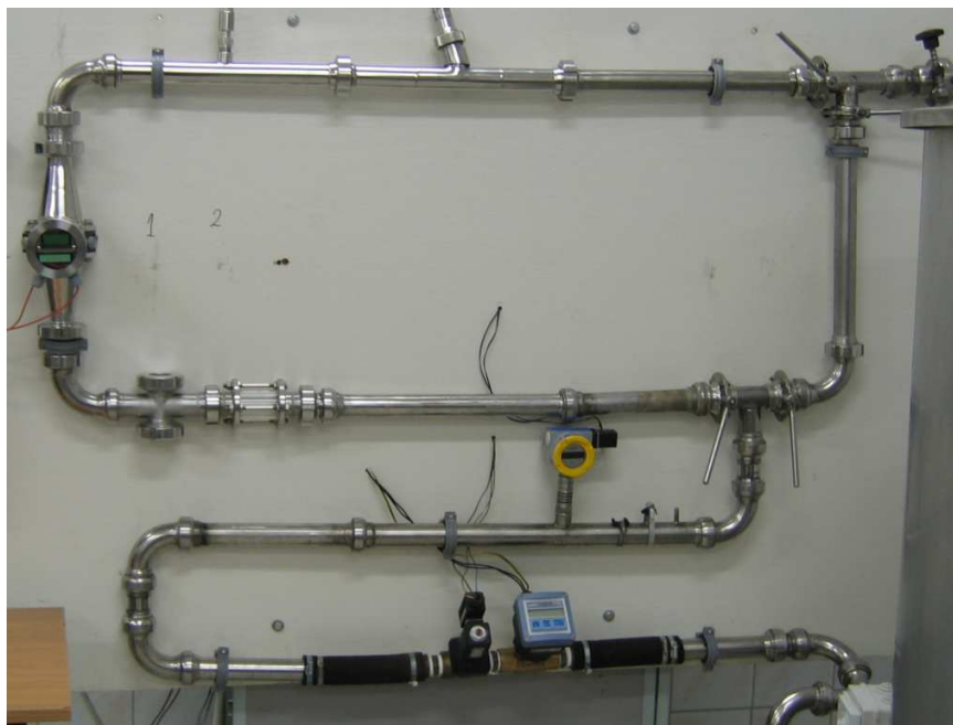
Rys. 7.4. Fotografia instalacji rurowej
