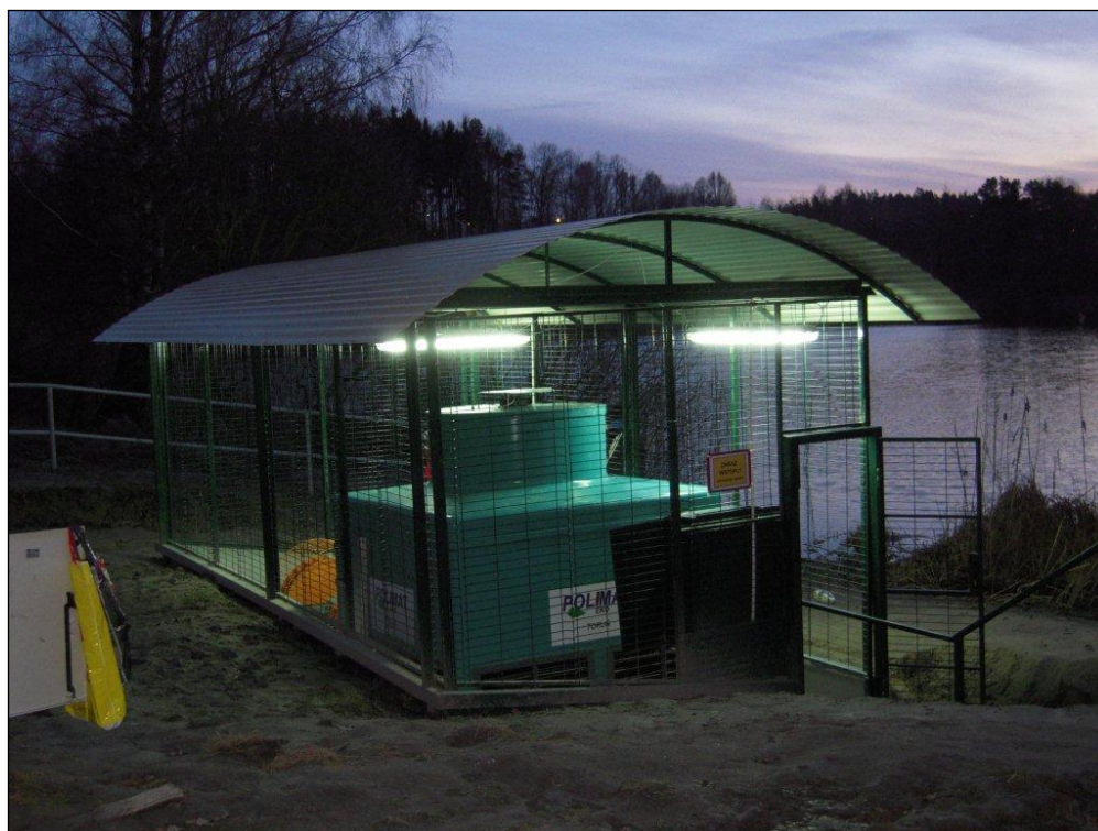
Rys. 3. Urządzenie firmy PolimatEko zainstalowane nad Jeziorem Starodworskim w Olsztynie (Fot. J. Sztramski)
