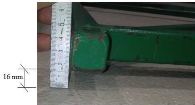
Rys. 5.3. Zaobserwowana wstępna deformacja przestrzenna kratownicy względem posadzki
