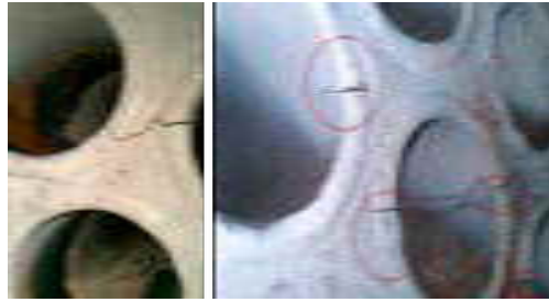
Ryc. 24 Pęknięcia w ścianie sitowej komory nawrotnej od strony spalin
