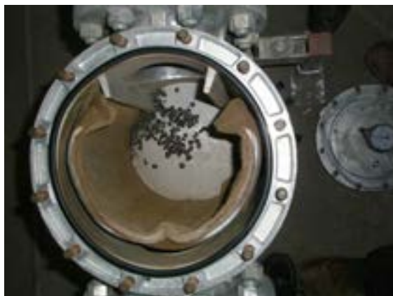
Ryc. 31 Odpryski pospawalnicze i nalot z rdzy w filtrze gazu
