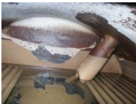
Ryc.23 Osady kamienia kotłowego od strony wody w obszarze płomieniówek i na ścianie sitowej kotła
