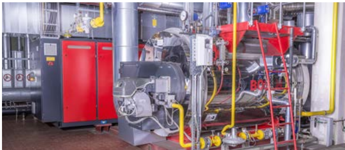
Ryc. 61 Moduł kogeneracyjny z 4-ciągowym kotłem odzysknicowym
