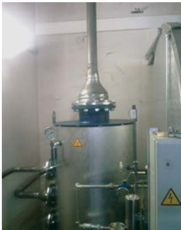
Ryc. 17 Zwężenie przewodu pary wtórnej może prowadzić do wzrostu ciśnienia w zbiorniku i w konsekwencji do jego rozerwania
