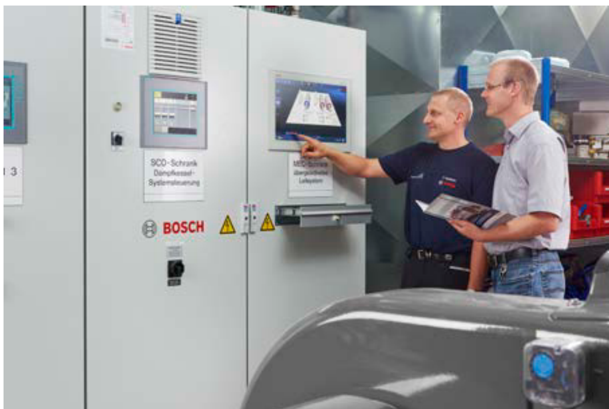
Ryc. 117 Szafy sterownicze systemów sterowania SCO i MEC System
