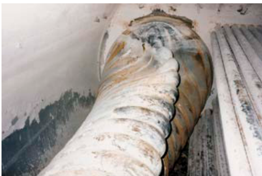
Ryc. 90 Kamień kotłowy, który spowodował uszkodzenie płomienicy
