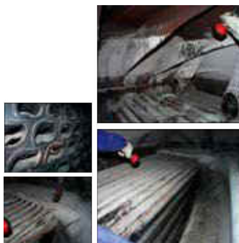
Ryc. 25 Warstwa tłuszczu i zanieczyszczenia w kotle skutkujące odkształceniami płomienicy i wewnętrznej komory nawrotnej w wyniku przegrzania
