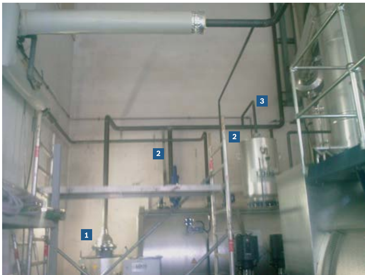
Ryc. 18 Zwężenie (1) przewodu pary wtórnej przy rozprężaczu odmulin. Łączenie (2) przewodu pary wtórnej, przewodu wydmuchowego zaworu bezpieczeństwa i przewodu oparów. Przewodu oparów niewykonany ze stali nierdzewnej (3).
