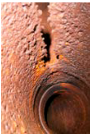
Ryc. 15 Skutki wprowadzenia ścieków o temperaturze przekraczającej 100 °C do zbiornika odmulin poniżej linii wody (przez króciec przeznaczony do temperatury < 100 °C)
