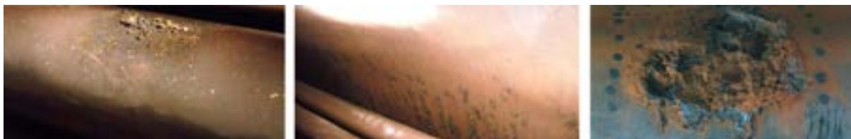
Ryc. 95 Uszkodzenia wywołane korozją tlenową w kotle i rurach
