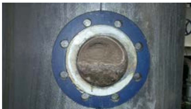
Ryc. 32 Zdemontowane przyłącze przelewu modułu rozprężania i schładzania odsolin i odmulin, moduł kompletnie zarośnięty kamieniem od wewnątrz
