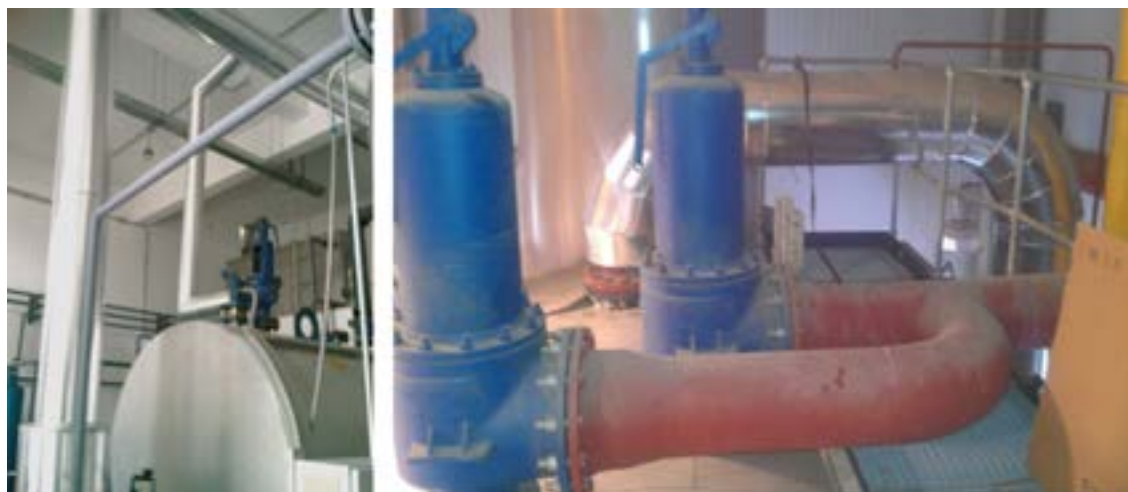
Ryc. 16 Niedopuszczalne łączenie przewodów wydmuchowych zaworów bezpieczeństwa i przewodów pary wtórnej
