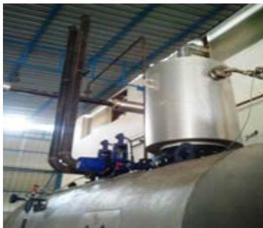
Ryc. 20 Brak zamocowań przewodów wydmuchowych zaworów bezpieczeństwa
