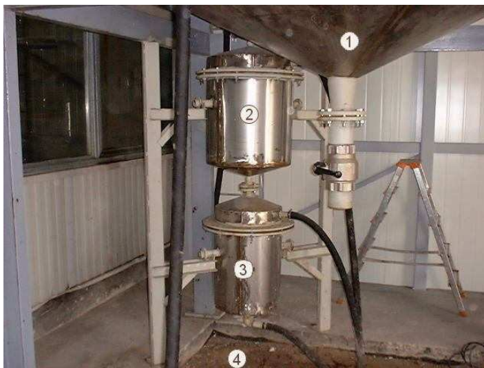
Fot. 1. 1 - zbiornik koagulacyjny, 2 - filtr grawitacyjny żwirowy, 3 - kolumna sorpcyjna, 4 - filtr piaskowy grawitacyjny z drenażem
