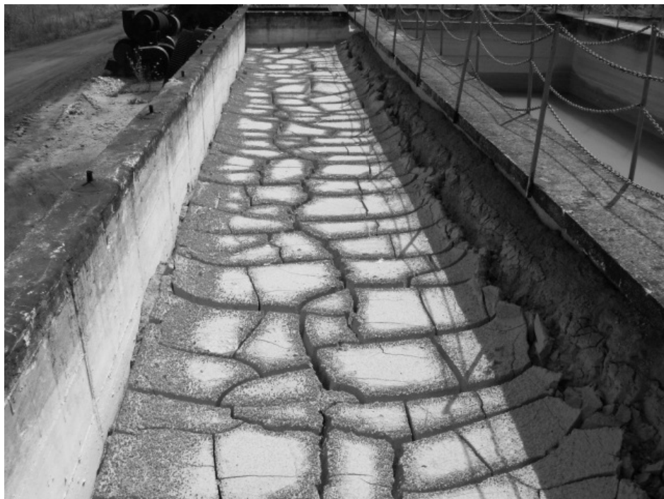
Fot. 2. Filtr piaskowy obiegu wodno-mułowego zakładu PREFABET w Redzie Photo 2. Sand filter in water-sludge circuit in PREFABET Company in Reda
