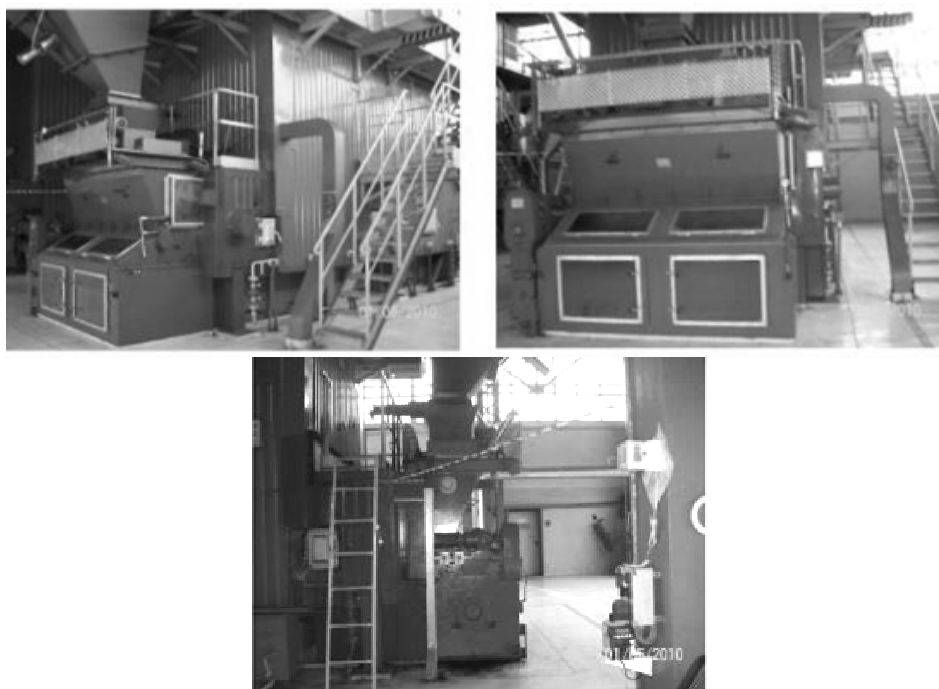
Rys. 1. Kotłownia Ciepłowni w Strzelcach Opolskich Fig. 1. Boiler Room of Heat Plant in Strzelce Opolskie
