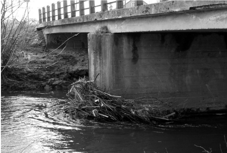
Rys. 1. Skutki nie najlepiej dobranego kształtu filara mostu Fig. 1. Results of inappropriately selected shape of bridge pier
