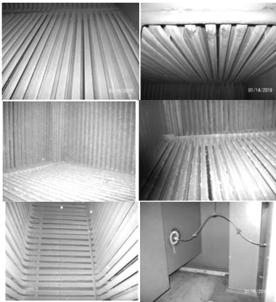
Rys. 4. Wnętrze kotła WR 15-N po zastosowaniu katalizatora Fig. 4. Interior of WR 15-N boiler after application of a catalyst
