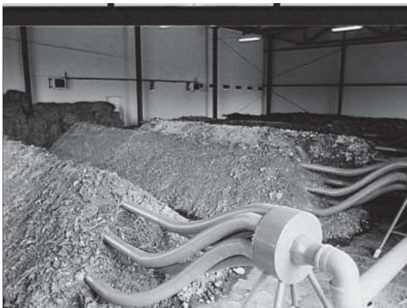
Rys. 4. Pryzmy kompostowe na Oczyszczalni ścieków w Sokółce
