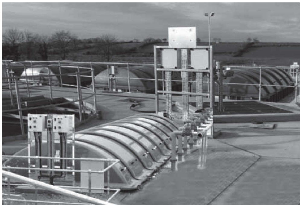
Rys. 4. Oczyszczalnia typu DN19S RBC – Kinallen, północna Irlandia Fig. 4. The wastewater treatment plant DN19S RBC – Kinallen, Northern Ireland
