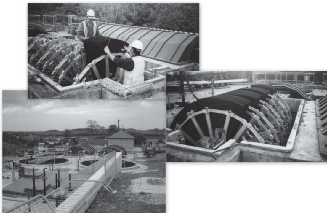
Rys. 2. Oczyszczalnia ścieków oparta o obrotowe złożo biologiczne Fig. 2. The WWTP with Rotating Biological Contactor
