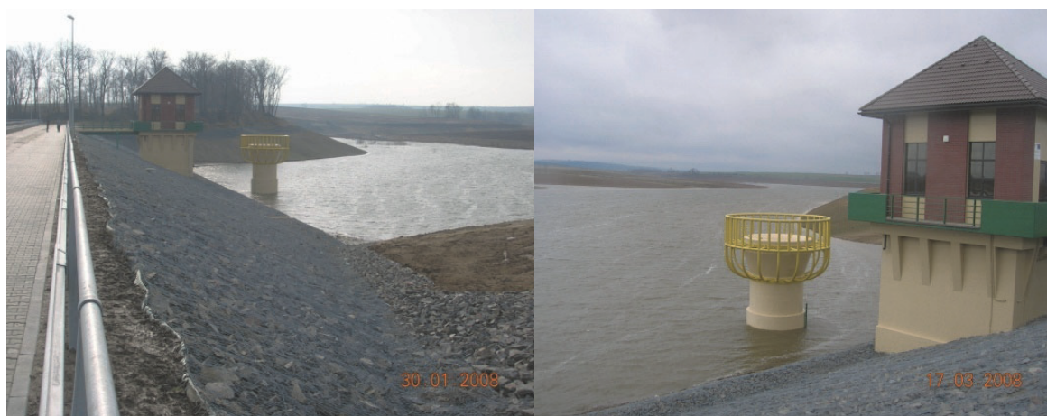
Rys. 2. Zbiornik Włodzienin – zapora zbiornika i upust wieżowy Fig. 2. Włodzienin reservoir – reservoir dam and tower spillway
