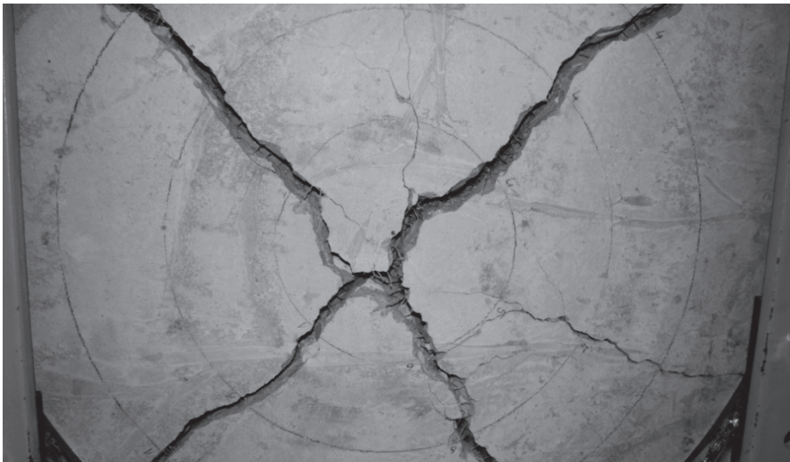
Fig. 5.6. Reinforced plate (E2-05) after several impacts, bottom view Rys. 5.6. Płyta zbrojona (E2-05) po serii uderzeń, widok z dołu
