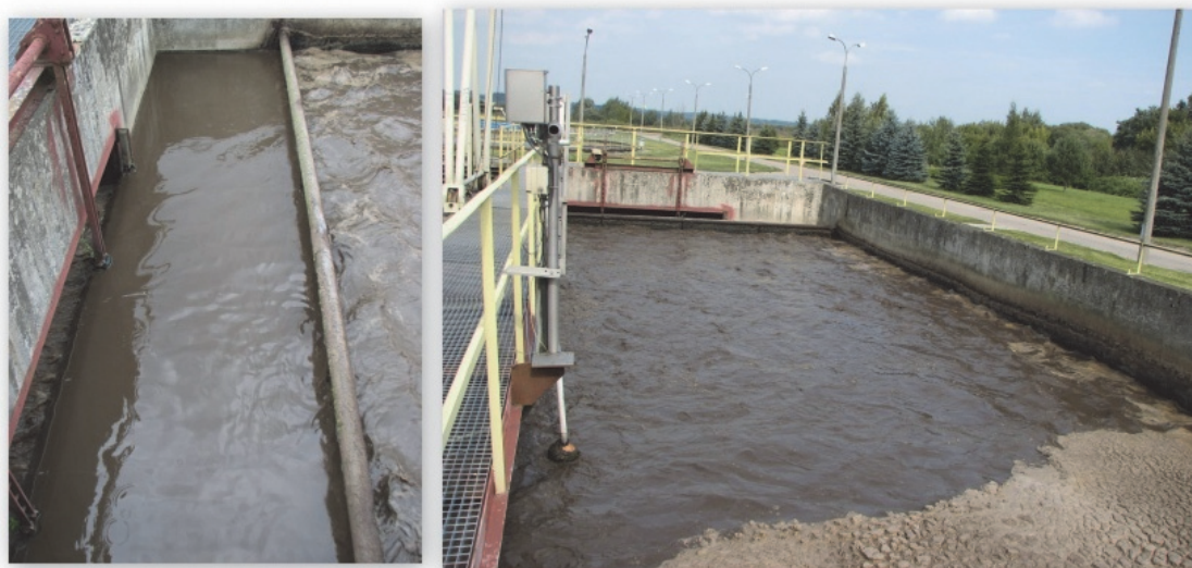
Rys. 9. Strefa nitryfikacji IV oraz wylot z komory osadu czynnego Fig. 9. Nitrification zone IV and outlet from activated sludge chamber
