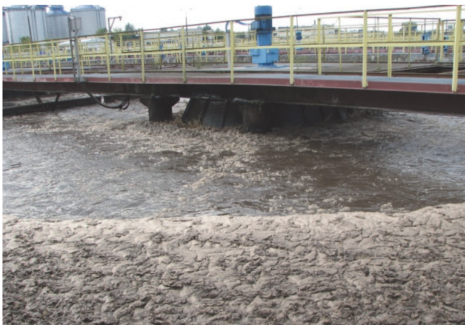
Rys. 8. Strefa nitryfikacji I Fig. 8. Nitrification zone
