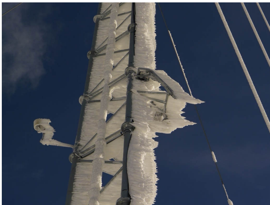
Rys. 1.26. Oblodzenie segmentu trzonu masztu w formie chorągiewek szadzi (fot. WINDHUNTER)
