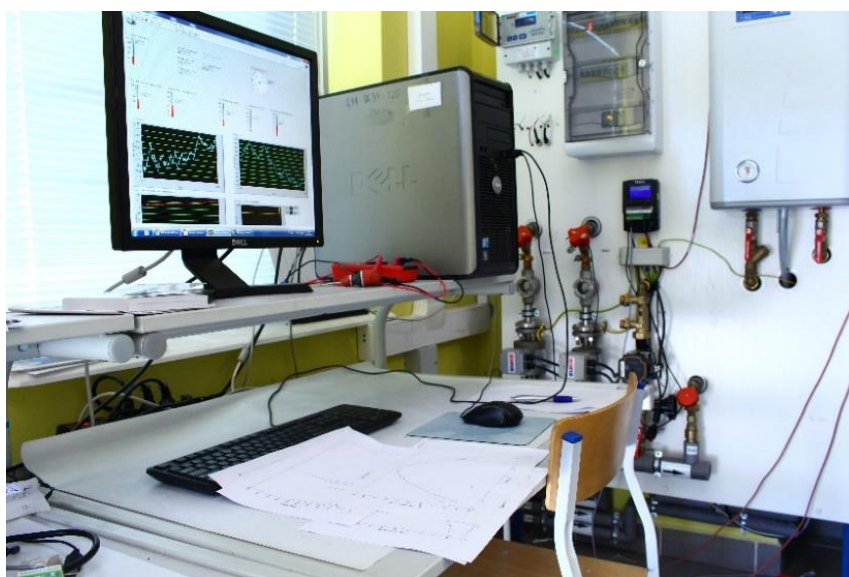
Rys. 3.15. System akwizycji danych z uruchomioną aplikacją pomiarową
