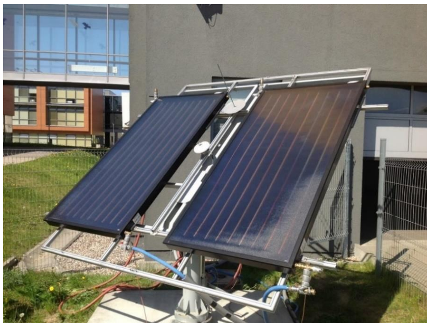
Rys. 3.16. Bateria kolektorów słonecznych zamontowana na platformie zewnętrznej
