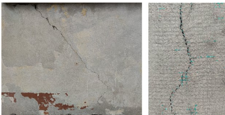
Rys. 8. Obiekt badań I etapu programu badawczego - przykładowe pęknięcia powierzchni ścian obiektów budowlanych.
