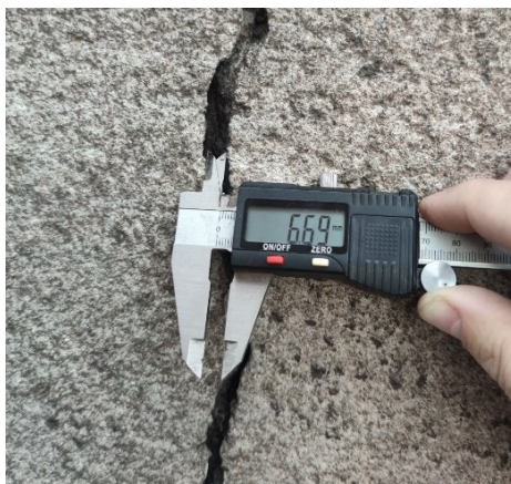
Rys. 14. Fotografia analizowanego pęknięcia; obiekt 3 [99].
