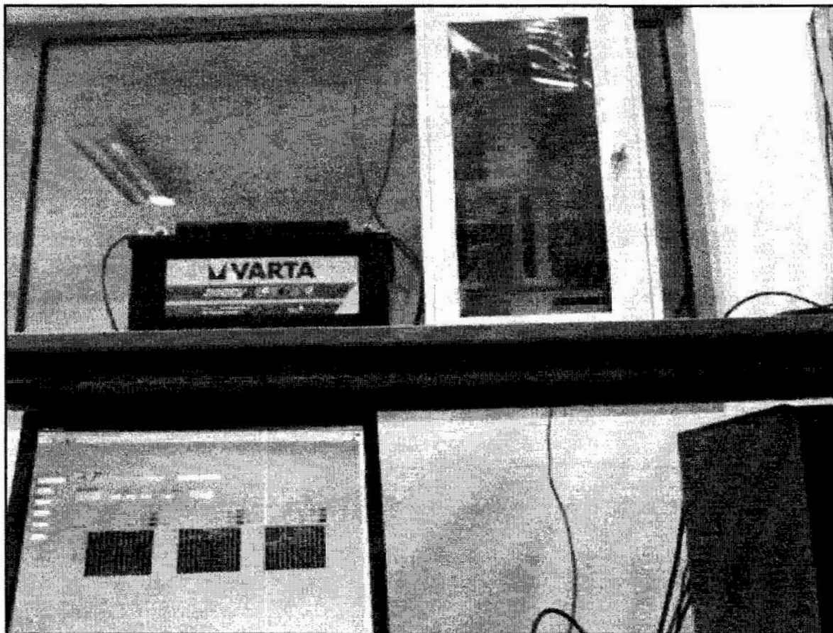
Rys. 3. Widok systemu fotowoltaicznego
